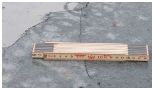
Figur 9. Revner pga. manglende udtøringsbeskyttelse.
