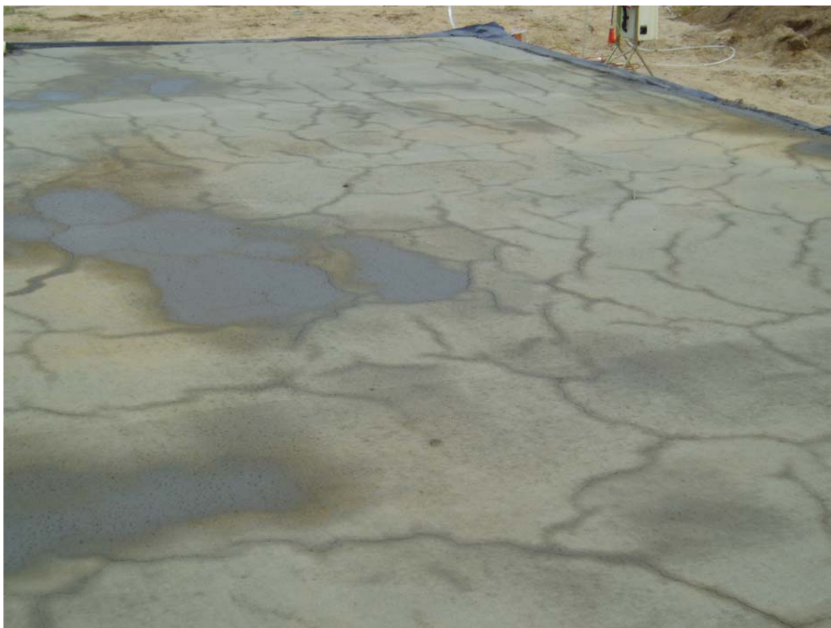
Figur 1: Plastiske svindrevner i nyudstøbt terrændæk.
